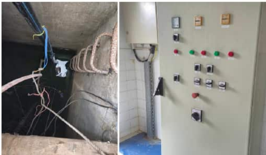
Slika 13 Bozen u izvorištu s crpkom i elektro ormar u objektu izvorišta
