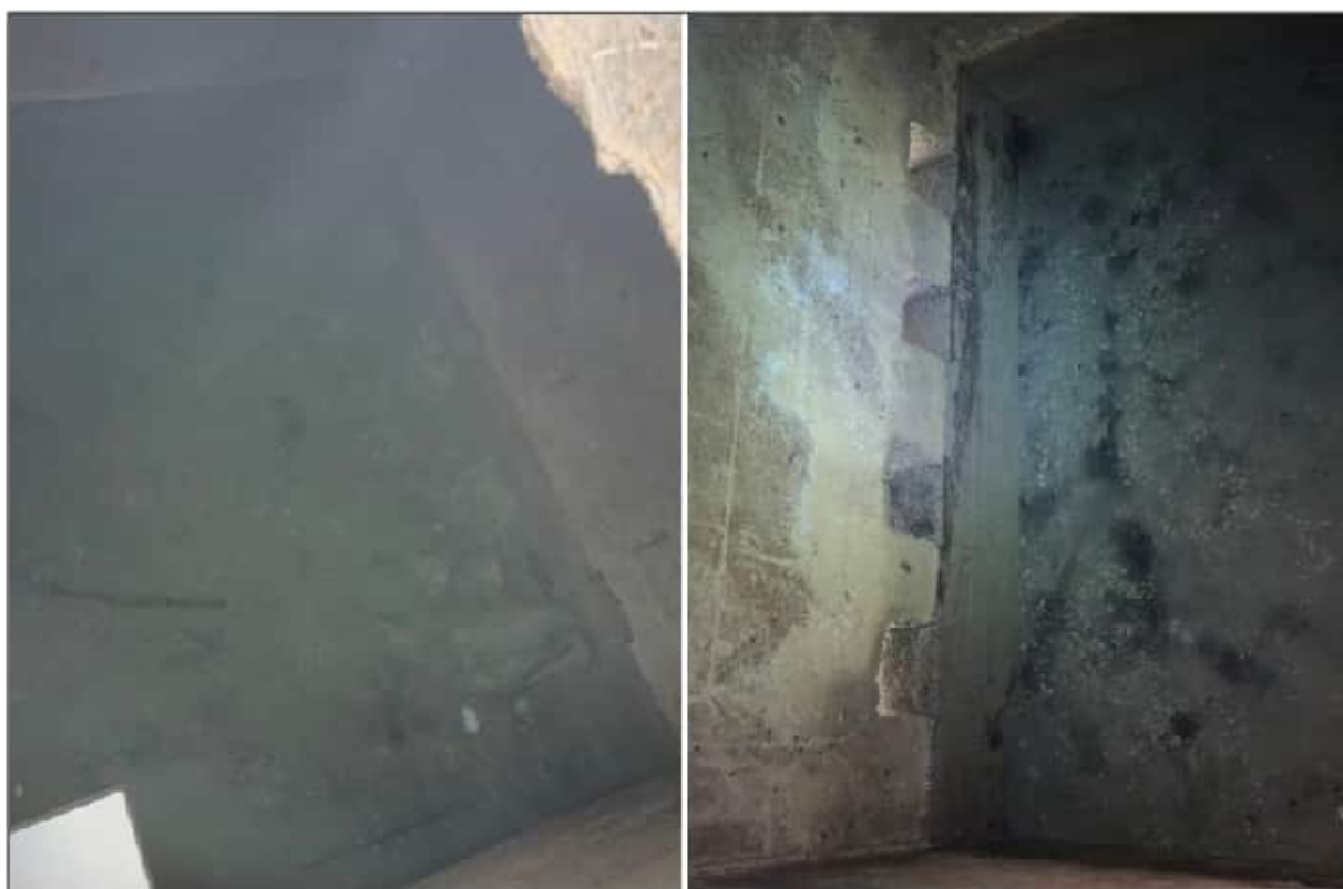
Slika 5. Izvor vode iz stijene u objekt kaptaze (lijevo) i prodori za istjecanje vode u Koranu (desno) (Izvor: Hidrološki elaborat, IDT d.o.o., Osijek, travanj 2026.)
