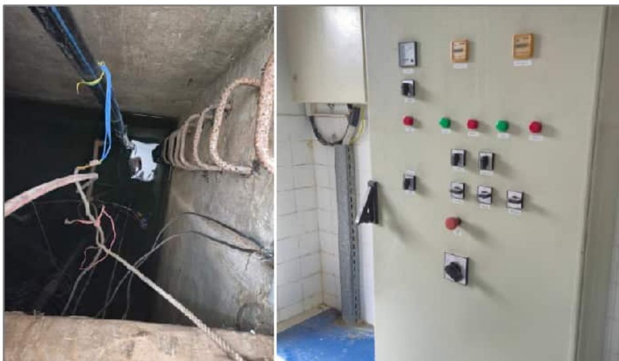
Slika 4. Bazen u izvorištu s crpkom i elektroormar u objektu izvorišta (Izvor: Hidrološki elaborat, IDT d.o.o., Osijek, travanj 2026.)
