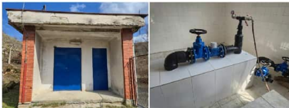
Slika 12. Objekt izvorišta i unutrašnjost (cjevovod od bazena prema farmi)
