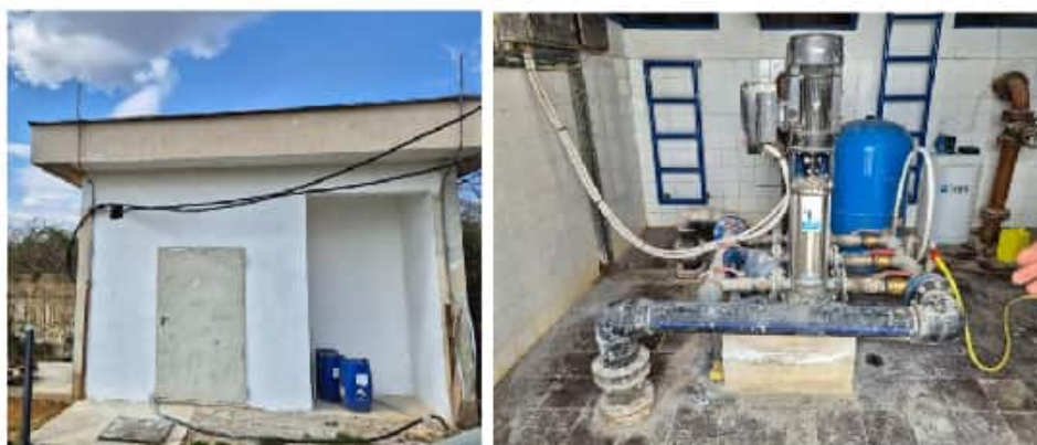
Slika 8 Objekt vodospreme i oprema u vodospremi
