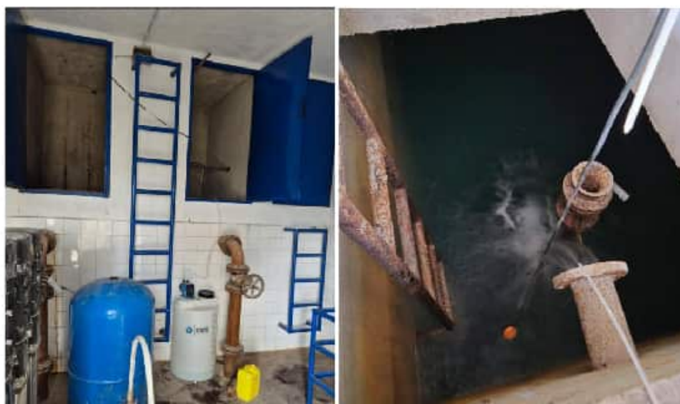
Slika 10 Revizijsko okna vodospreme i ulaz vode u vodospremu od izvorišta
